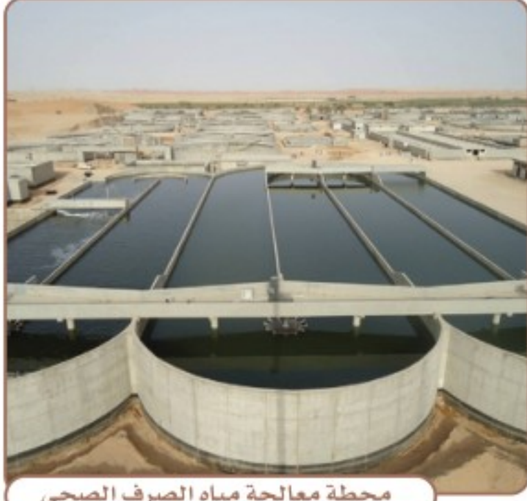
محطة معالجة مياه الصرف الصحي
